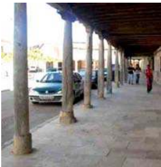
Mediante una base de piedra, se evita el contacto directo de la madera con el suelo.
